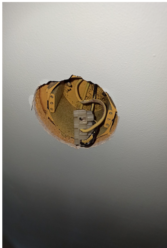
Kuva 12, avattu, levyn alla ollut liitos.
