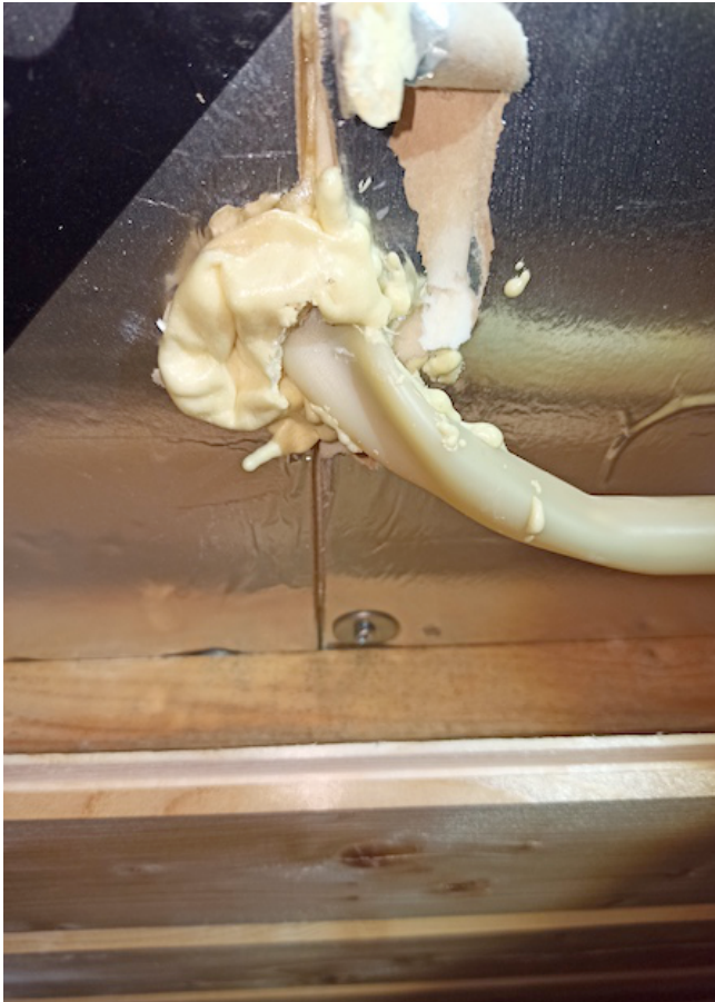
Kuva 16, väkisin väännetty putki
