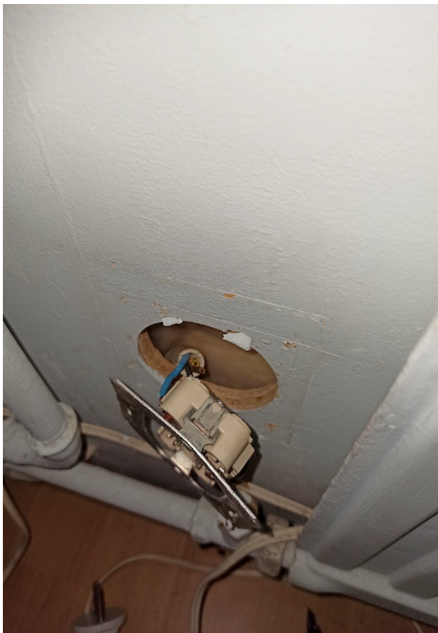
Kuva 10, vaatehuoneen pistorasia ilman kojerasiaa
