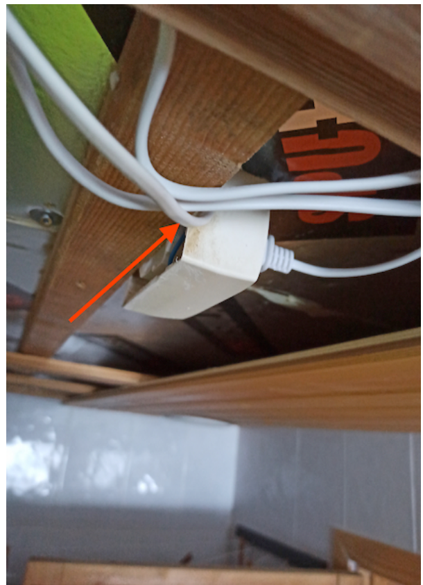
Kuva 18, pistorasia välitilassa Väärä kaapeli, asennusvirhe
