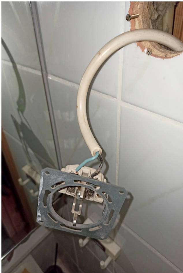
Kuva 24, WC pistorasian maadoitus puuttuu ja asennus ilman kojerasiaa.
