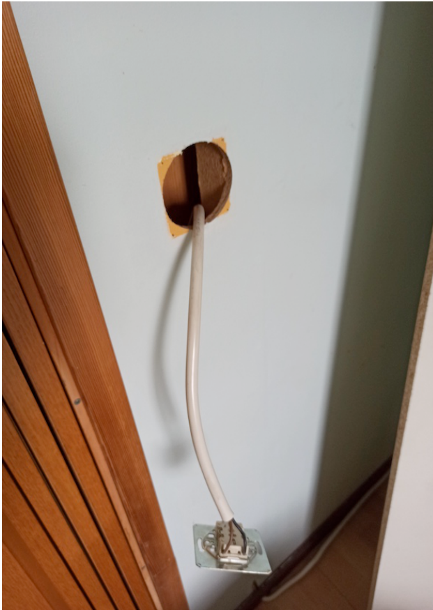
Kuva 9, vaatehuoneen valokytkin ilman asianmukaista kojerasiaa.
