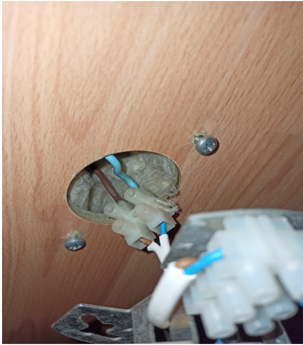
Kuva 28, siivouskomeron valaisimen liitos.
