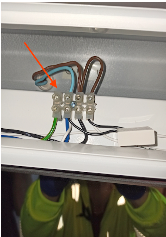
Kuva 25, WC peilivalaisin, maadoitus puuttuu
